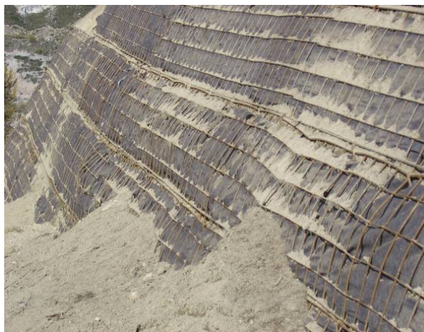
Figura 8. Deteriorări ale cofrajelor datorate compactării insuficiente
